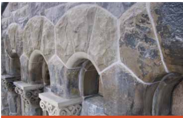
Les pierres du clocher à remplacer ont été marquées (à gauche). Après un soigneux nettoyage et un rejointement, les résultats sont impressionnants (à droite).
