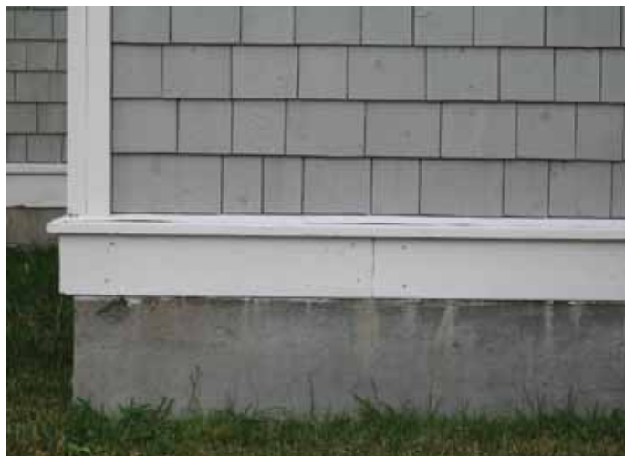
Détail illustrant la façon dont un parement en bois est protégé de la remontée d'eau depuis la fondation.
