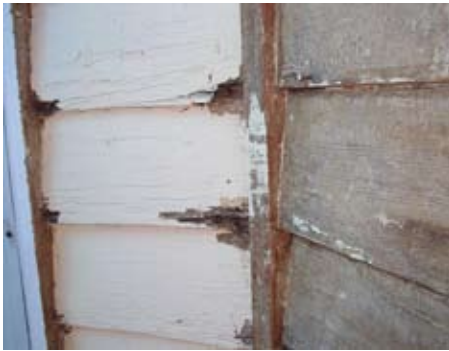
Fendillements, clous émergeant et bois de bout pourri.
